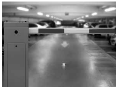
Шлагбаум, управляемый ПЧ ATV 12
