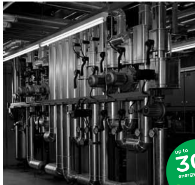
Управление насосной станцией
